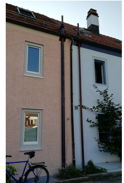
Abgasleitung links in Kupfer, rechts in Kunststoff
